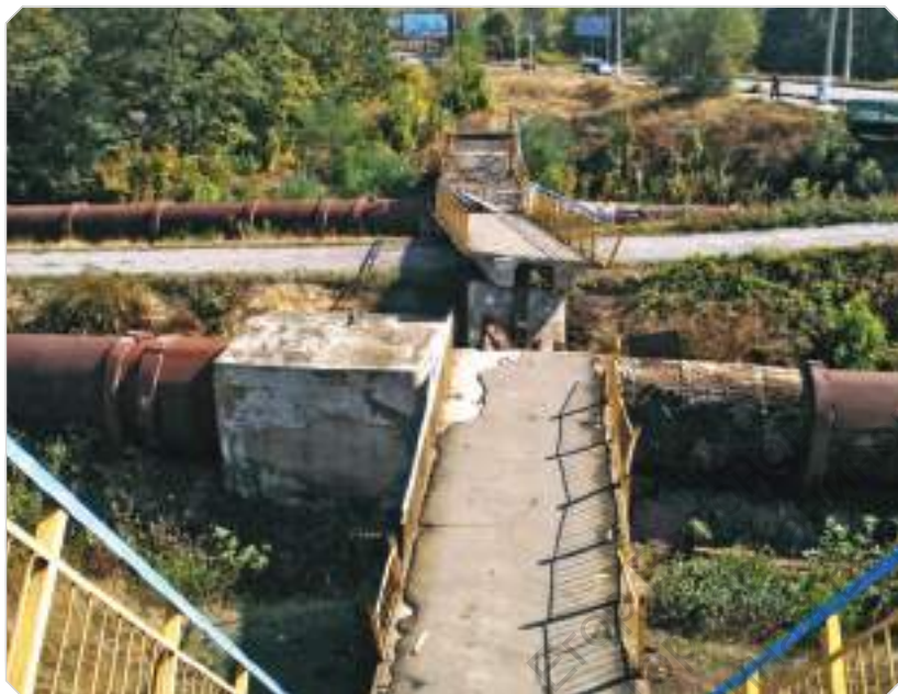
Взорванный ополченцами пешеходный мост возле 245 квартала 5 августа 2014 года
