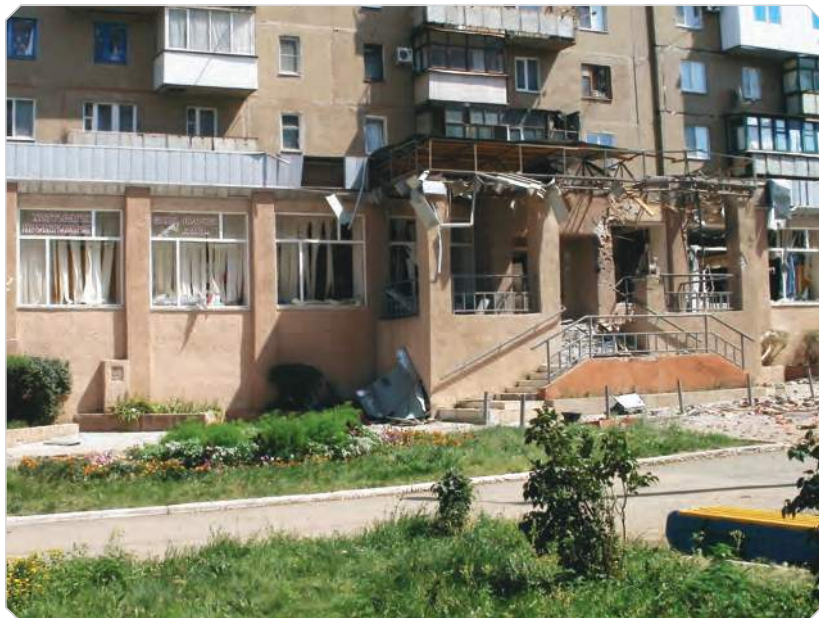
Ж/м «Строителей» после артобстрела, 29 июля 2014 года
